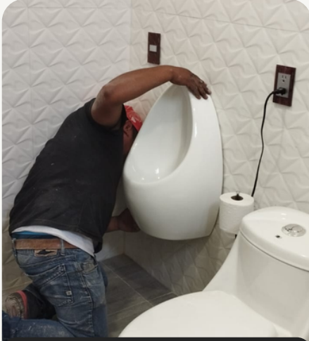
Plomería y sanitarios
