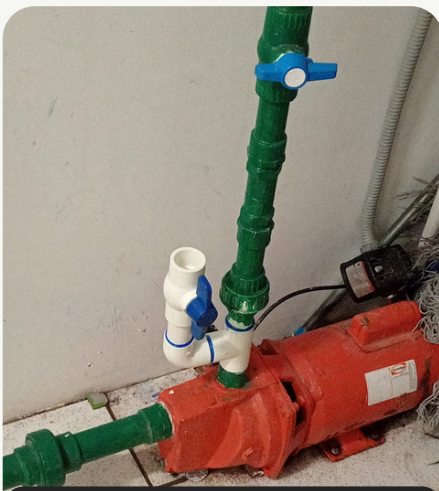
Bombas y funcionamiento
